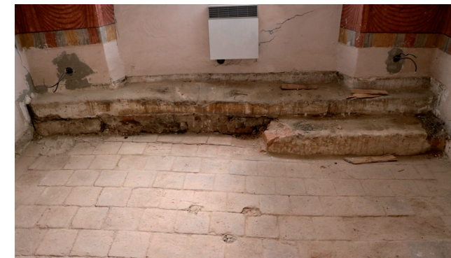
Sesutá podlaha a vlevo patrný „vyrovnávací“ schůdek
