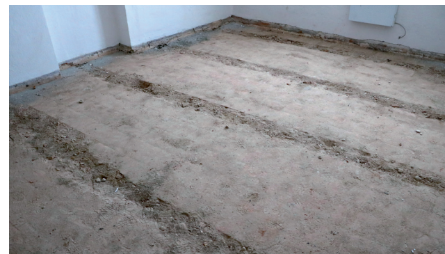
V zachované dlažbě druhé výstavní místnosti jsou patrné vytrhané pásy po druhotně umístěném dřevěném roštu
